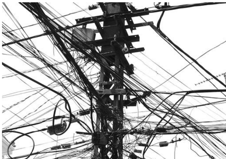
Bild 1: Wer schon einmal die USA bereist hat, ist immer wieder erstaunt über die „gewagte“ Verkabelungstechnik öffentlicher Stromnetze.
